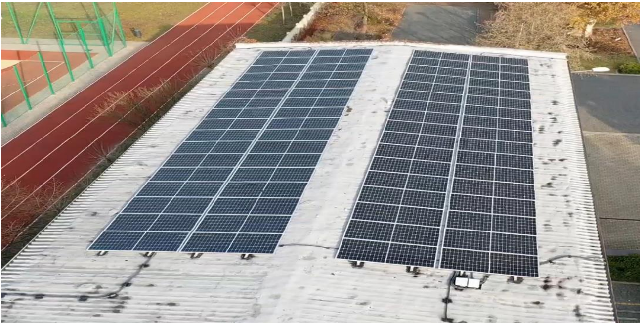
instalacja o mocy 30 kW w Nadleśnictwie Opole
