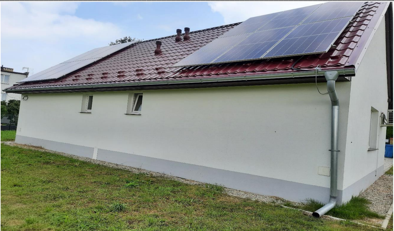
Instalacje na budynkach kancelarii leśnych
