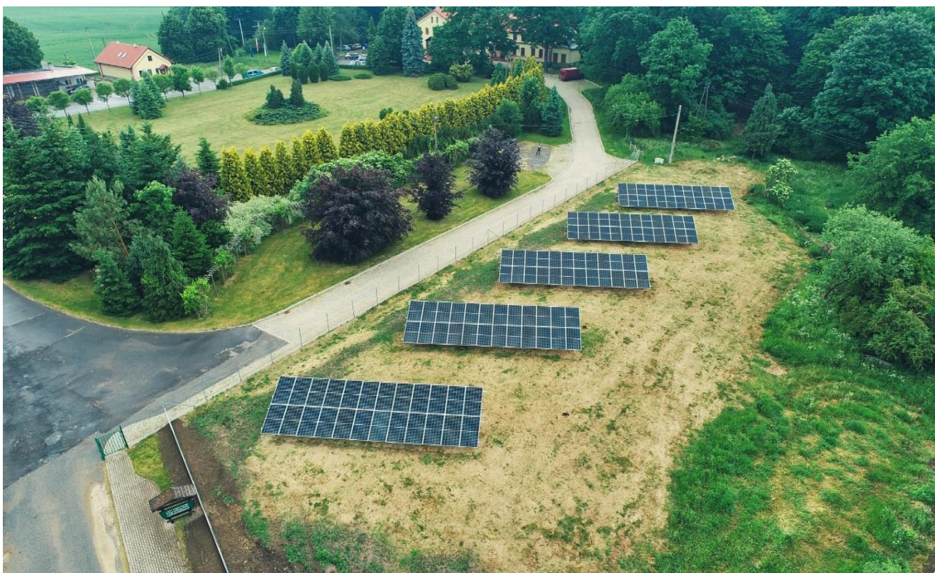
instalacja o mocy blisko 50 kW na gruncie w Nadleśnictwie Łopuchówko
