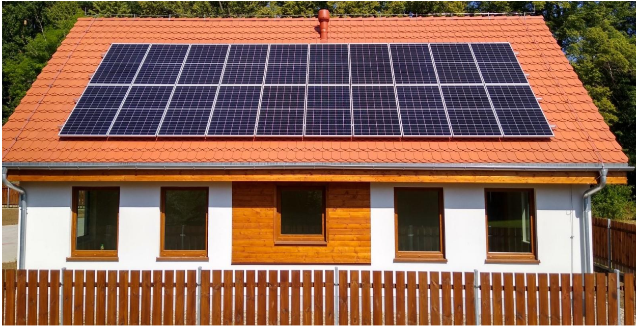
instalacja na budynku kancelarii leśnictwa w miejscowości Wyszki
